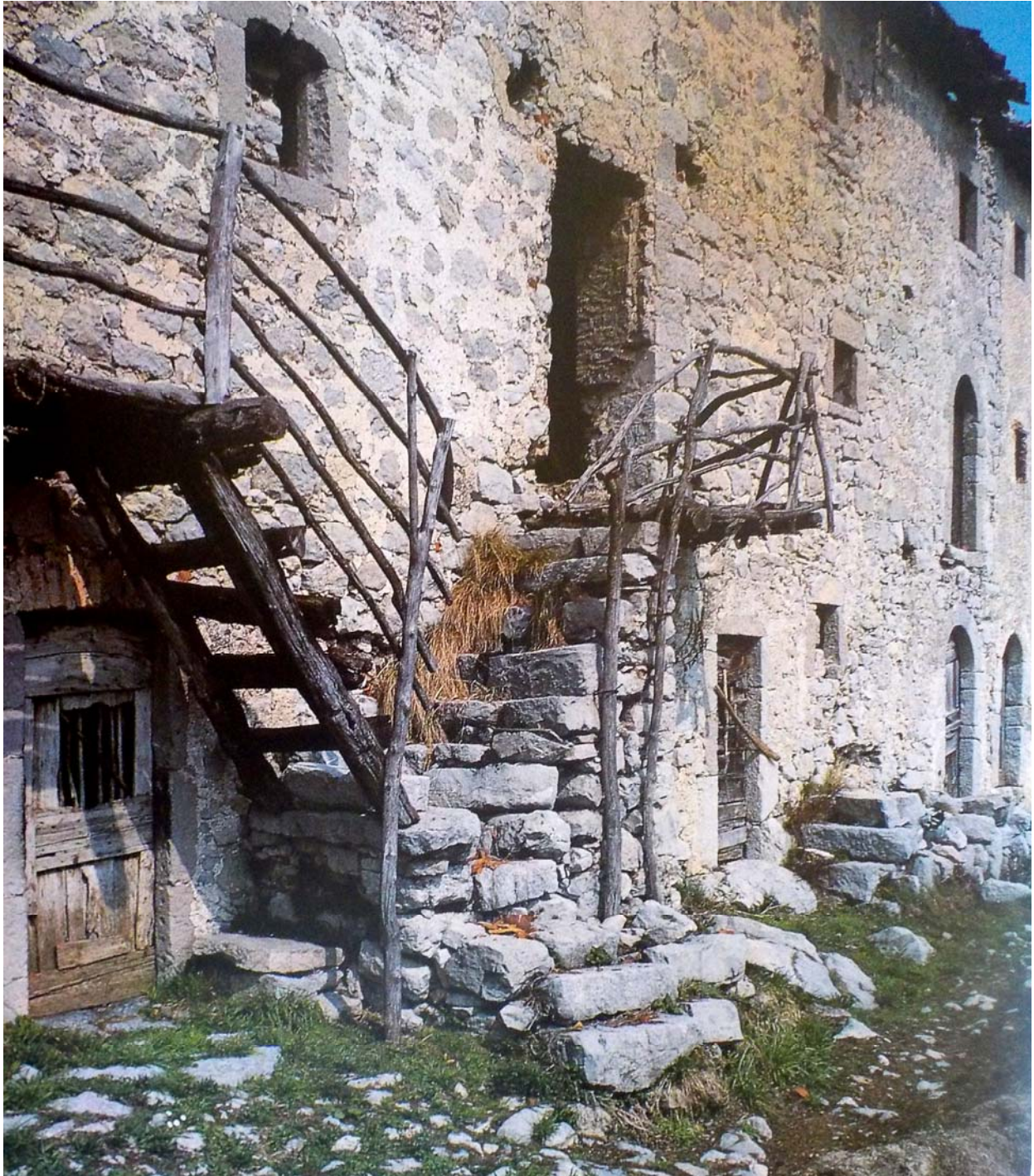
Crosello au début des années nonante. Photo tirée de l'ouvrage sur Catremerio de 1992. Qui oserait encore rentrer dans les différentes parties de ce complexe. A cause surtout des tuiles du toit souvent en un dangereux équilibre en bordure.
