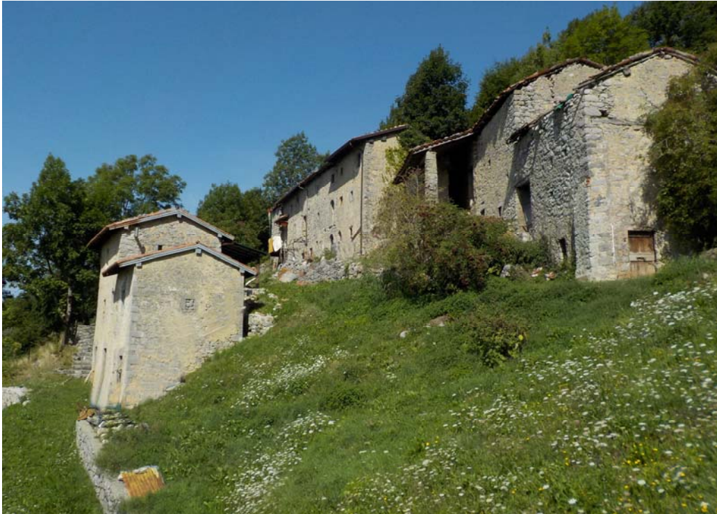
Ensemble de Crosnello avec les écuries à droite. La petite maison de gauche semble être encore passablement bien entretenue. L'ensemble de droite voit la présence d'un vacancier qui nous a fourni des indications utiles sur la situation actuelle du hameau.
