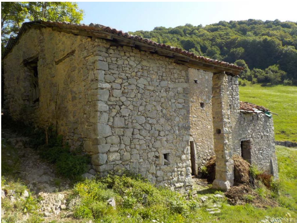
Les écuries et les granges en fonction encore aujourd'hui. Le toit de gauche est soutenu par un pilier en pierre à son angle droit.
